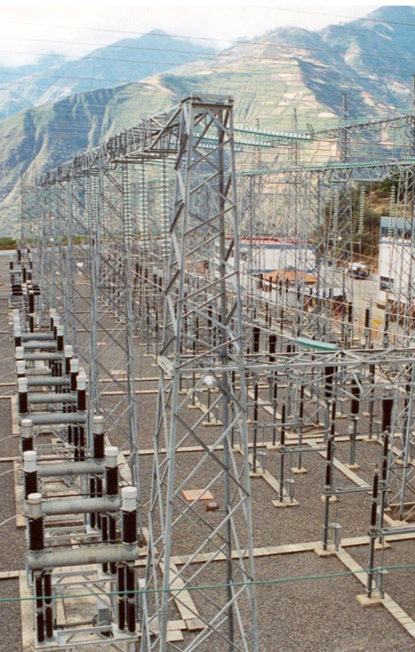
Producción de electricidad en Nueva Yanango-Nueva Huánuco.
